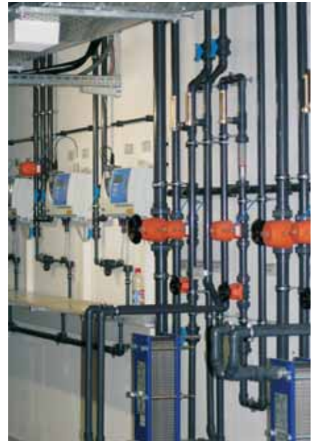
Wärmerückgewinnungen mit Messtechnik
