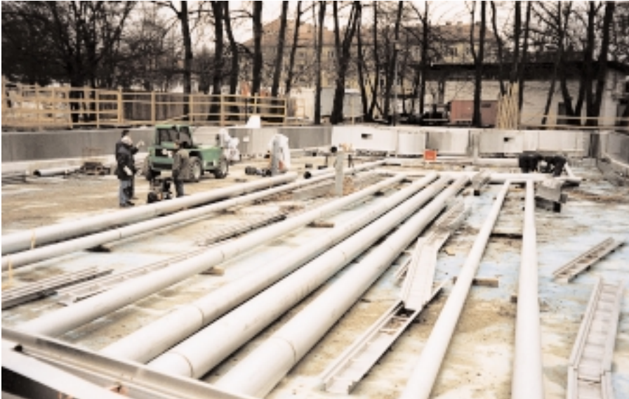
Zu- und Ablaufleitungen unter dem Edelstahlbecken
