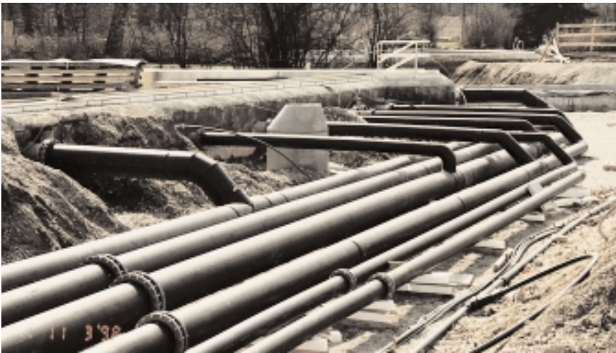
Zu- und Ablaufleitungen, im Erdreich verlegt, beherrschen die Landschaftsarchitektur im Ungererbad
