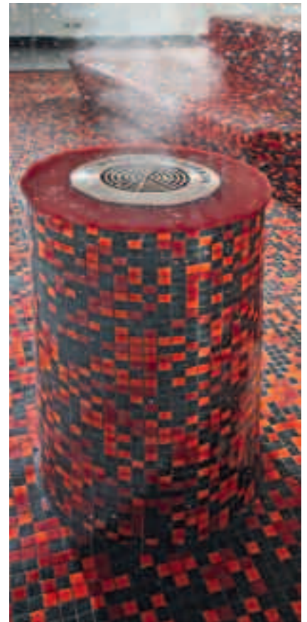
Der Dampfgenerator bei der Arbeit
