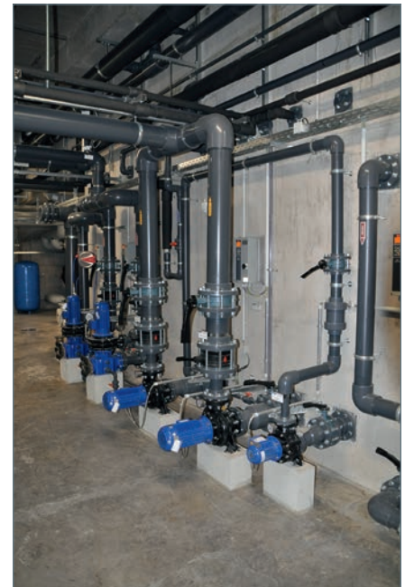
■ Umwälzpumpen der Badewasseraufbereitung
