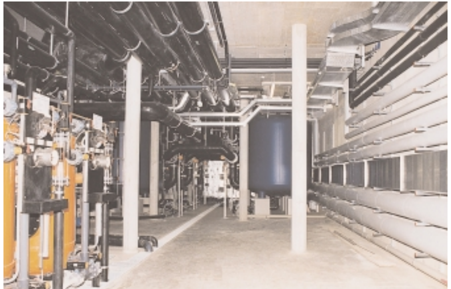
Installationen in der Badewasseraufbereitungsanlage
