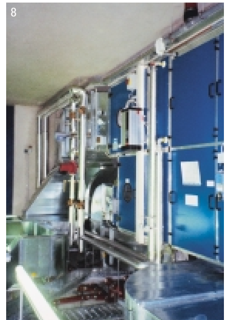
6 Mess- und Dosiertechnik 7 Schaltschrank Badewasser 8 Lüftungszentrale
