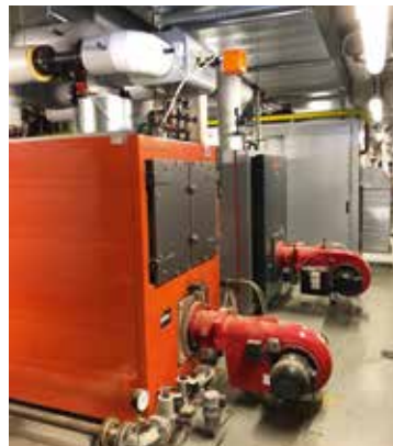
▲ Gasheizer zur Spitzenlastabdeckung
