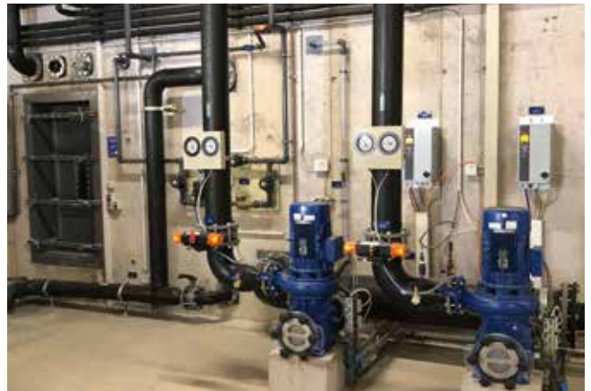
▲ Umwälzpumpen mit Einstieg Schwallwasserbehälter
