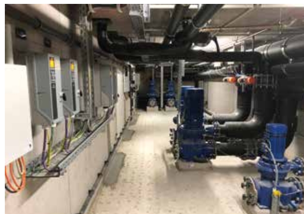
▲ Umwälzpumpen mit Frequenzumformer
