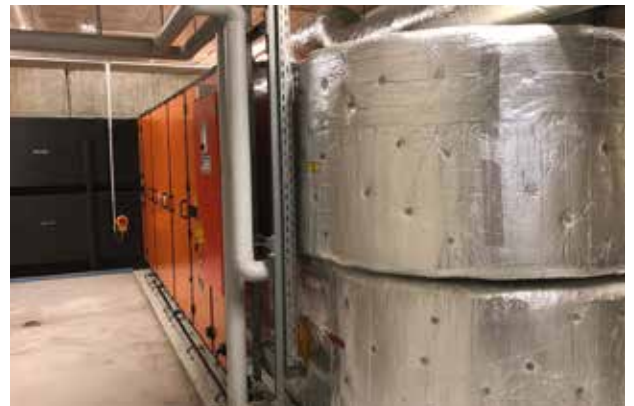
▲ Anschlüsse Lüftung Bestand
