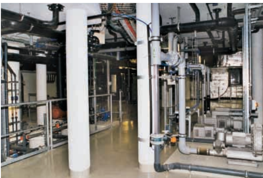
Fotos von oben nach unten: Drucksandfilter Badewasseraufbereitung
