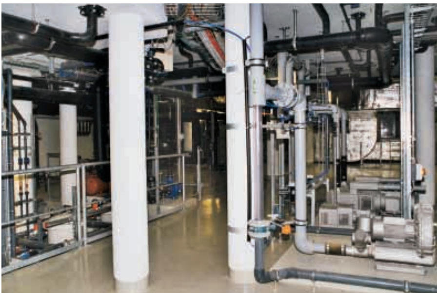
Fotos von oben nach unten: Drucksandfilter Badewasseraufbereitung
